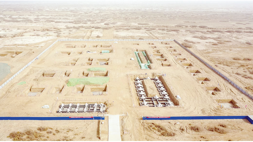
日前，国网巴州阳霞220千伏输变电工程项目建设顺利复工。图为项目建设现场。 通讯员 王骞 摄
